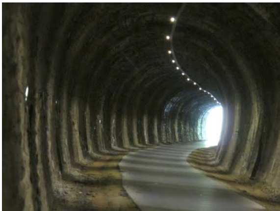
Intérieur du tunnel de Burziheid qui livre aujourd'hui le passage au Ravel.
